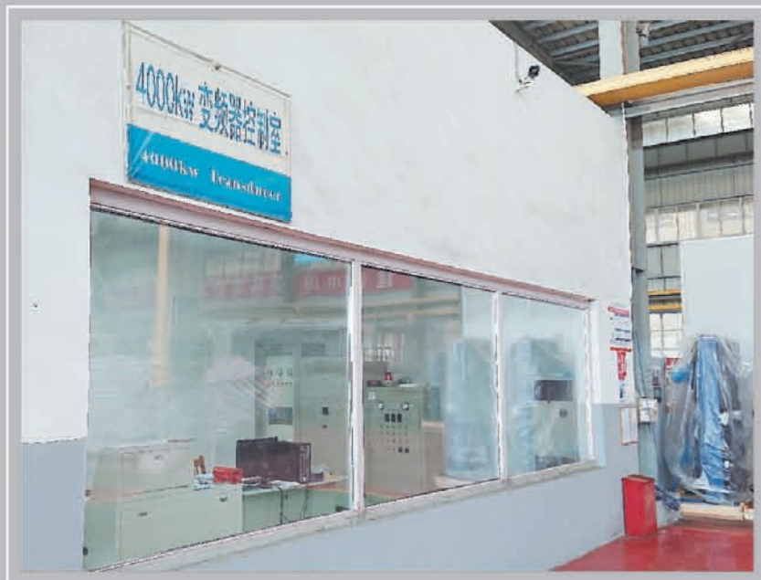
4000kW变频控制室 4000kW Frequency Converter Control Room
